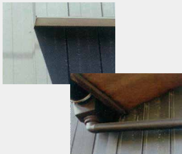
雨掛かりしにくい部分での早期腐食事例
