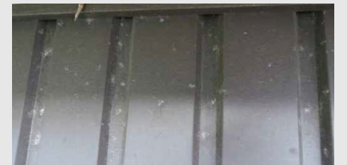
(a) 塗装GL：平面部からの白錆が多く見られる
