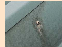
●タッチアップ塗装をしないビス類では写真の通り、固定ビスを中心に円形状に腐食が進みます。
