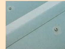
●ビス類は、固定後同色補修塗料を用いてタッチアップ塗装を行います。
