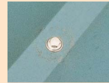
●樹脂キャップを使用しない場合は取り付けボルト部から腐食が広がります。
